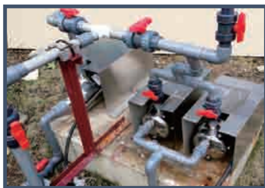
图3：改造后中水回收输水泵组
